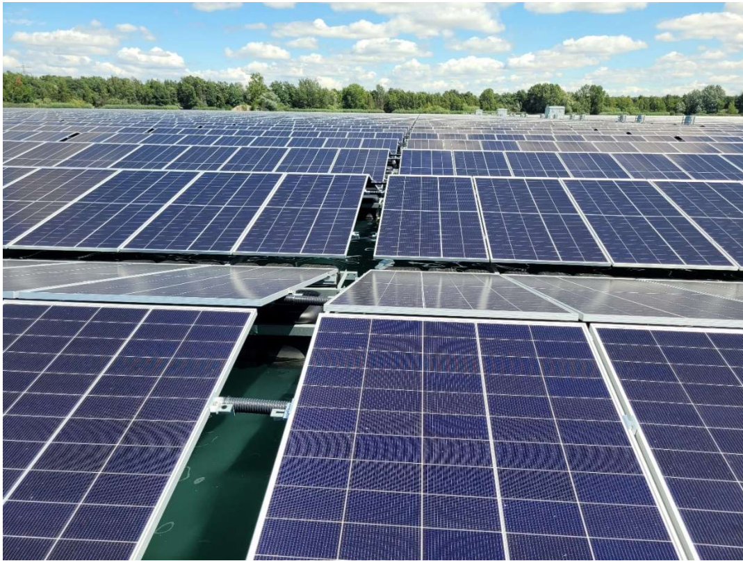
Abb.1: 8 ha große, schwimmende Photovoltaikanlage auf einem Baggersee der Ober- rheinebene (Foto: Dr. Frank Hartmann)
